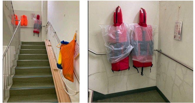
階段昇降設備の設置状況
