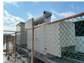
非常用自家発電設備棟屋外観
