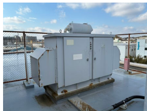
スプリンクラー用発電機
