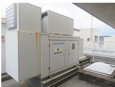
非常用自家発電設備の設置状況
