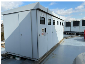
キュービクル (受変電盤)
