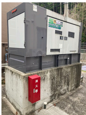
屋外非常用自家発電機の設置状況（※国補助金活用）
