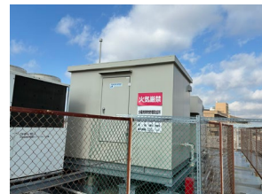
非常用自家発電設備用燃料庫 (3日分の燃料を備蓄)
