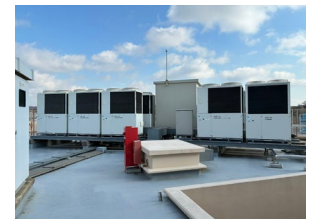
非常用自家発電設備用 燃料庫と空調室外機
