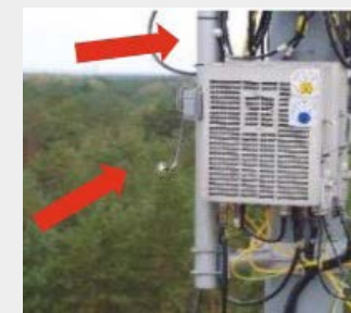
4. Kép: Adótornyokon található berendezések
